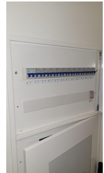
Elektrisk anlegg - [Sikringskap]
