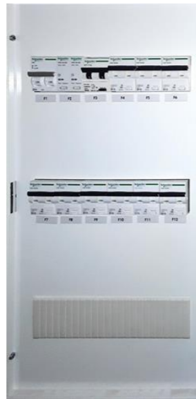
Elektrisk anlegg - [Sikringskap]
