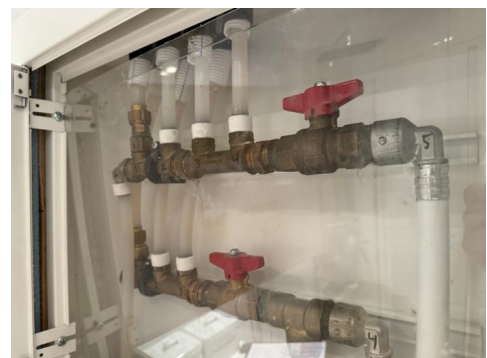
Stoppekraner i rør i rør skap.
