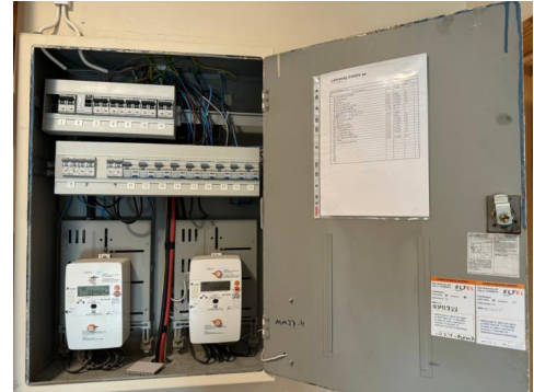
Sikringskap i fellesarealer.
