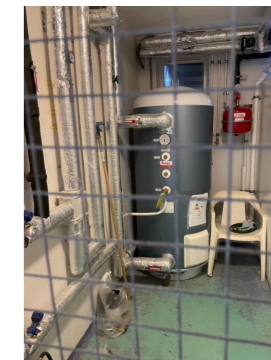
Varmtvannstank i teknisk rom i u-etg. Produsent: Oso Hotwater.
