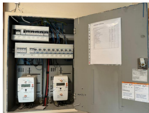
Sikringsskap i fellesarealer.
