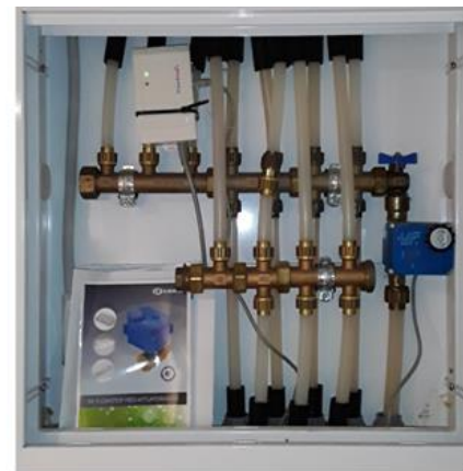
Tekniske anlegg, VVS anlegg (Sjekkpunkter utover det som er inkludert i andre rom) - [Fordelerskap til rør-i-rør system - Vaskerom]
