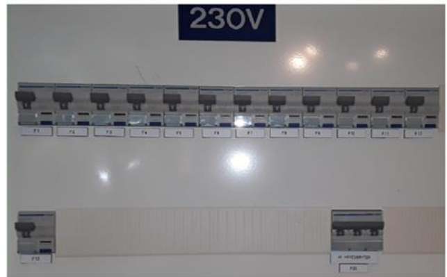
Elektrisk anlegg - [Sikringskap]
