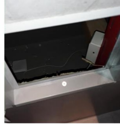
Tekniske anlegg, VVS anlegg (Sjekkpunkter utover det som er inkludert i andre rom) - [Automatisk vannstopper med sensor inne i vegg ved toalettsisterne - Toalettrom]
