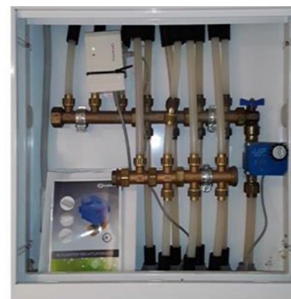
Tekniske anlegg, VVS anlegg (Sjekkpunkter utover det som er inkludert i andre rom) - [Fordelerskap til rør-i-rør system - Vaskerom]
