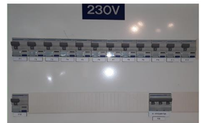
Elektrisk anlegg - [Sikringskap]
