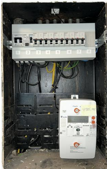
Elektrisk anlegg - [Sikringskap]
