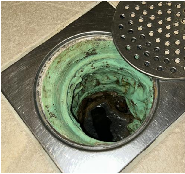
Våtrom - [Sluk på bad]
