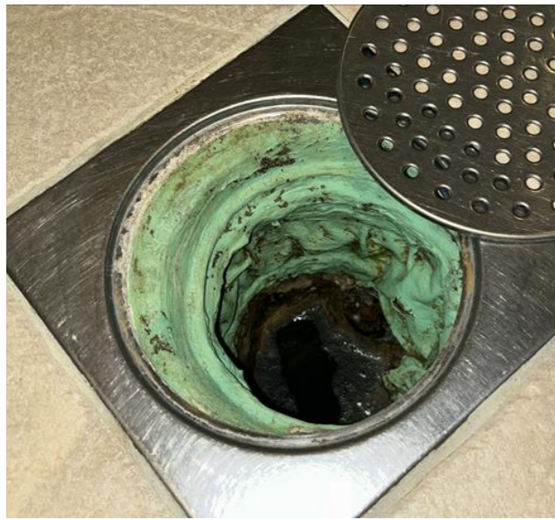
Våtrom - [Sluk på bad]
