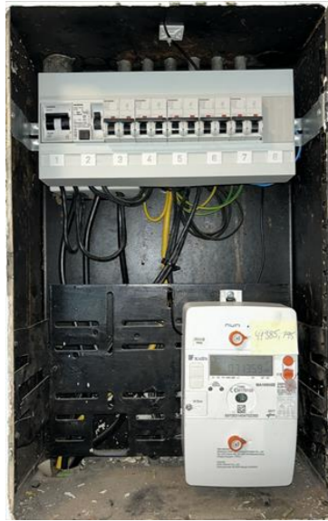
Elektrisk anlegg - [Sikringskap]
