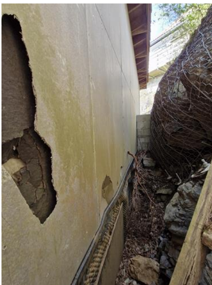
Frittstående byggverk - [Skade vegg annek]
