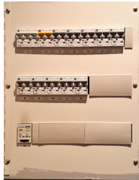
Elektrisk anlegg - [Sikkeringskap]
