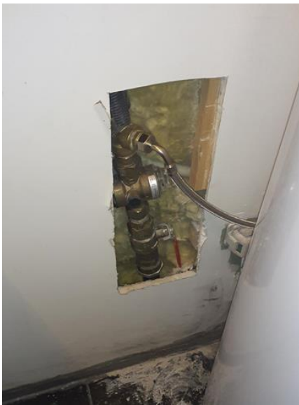
Våtrom - [Hull i vegg vaskerom]
