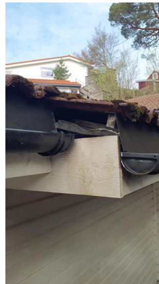
Yttertak - [Avlusning ikke fullført, vann ledes inn på undertak og lekter. Tiltak må påregnes.]
