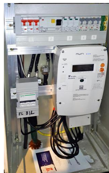
Elektrisk anlegg - [Inntaksskap]
