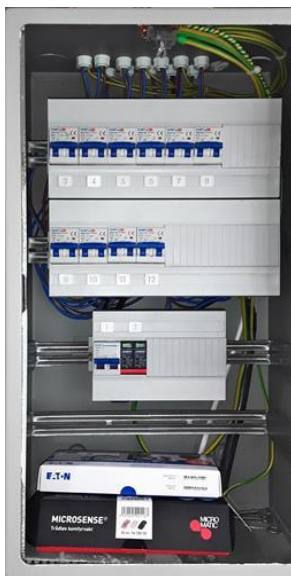
Elektrisk anlegg - [Sikringskap]
