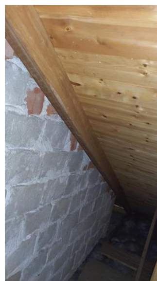
Brann - [Brannhemmende plater ikke montert]
