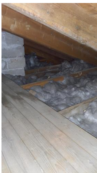
Brann - [Åpning inn på naboloft]
