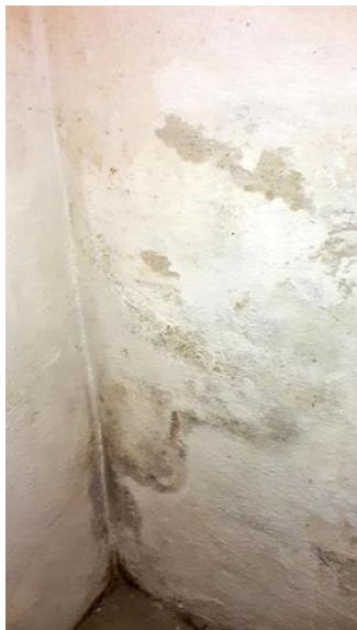
Rom under terreng (kjeller, underetasje, sokkeletasje) - [Salt utslag 2]
