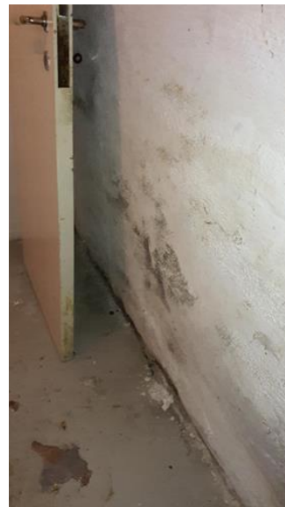
Rom under terreng (kjeller, underetasje, sokkeletasje) - [Salt utslag]
