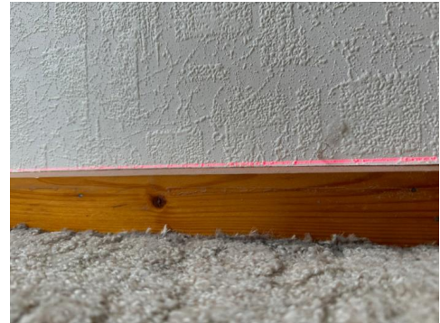
Bilder viser skjevheter i gulv i stue.
