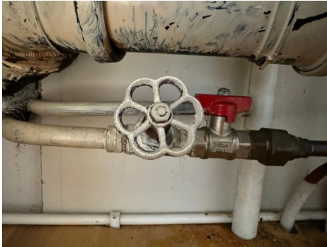
Stoppekran i kjøkkenskap.
