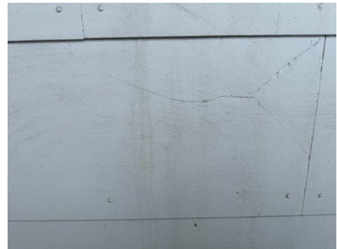
Knekt eternitt/asbestplate på fasade v/ altan (Brl's ansvar).
