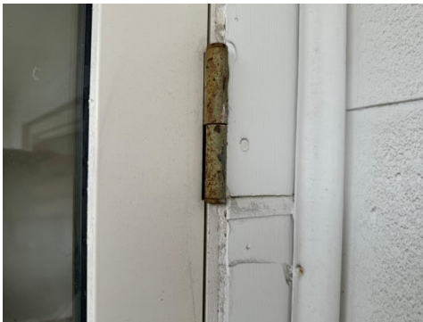
Rust på hengsel til altandør.
