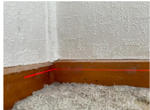
Bilder viser skjevheter i gulv i stue.
