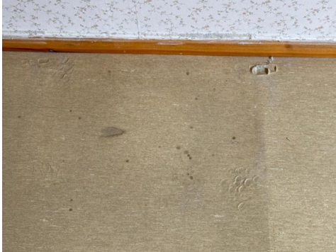
Slitasje i belegg på hovedsoverom.
