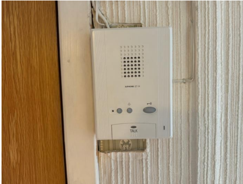
Dørtelefon i entre/gang.
