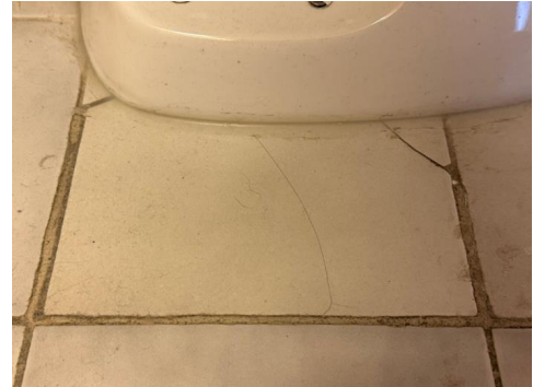
Sprekker i gulvflis v/ toalett.
