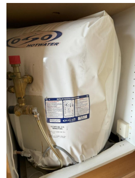
Varmtvannstank i kjøkkenskap.
