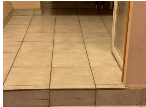
Sprekker i fliser v/ oppkant.
