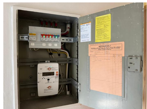
Sikringsskap i fellesarealer.
