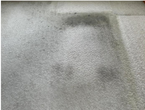
Misfarging i teppe i stue.
