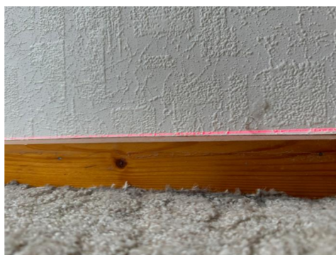
Bilder viser skjevheter i gulv i stue.
