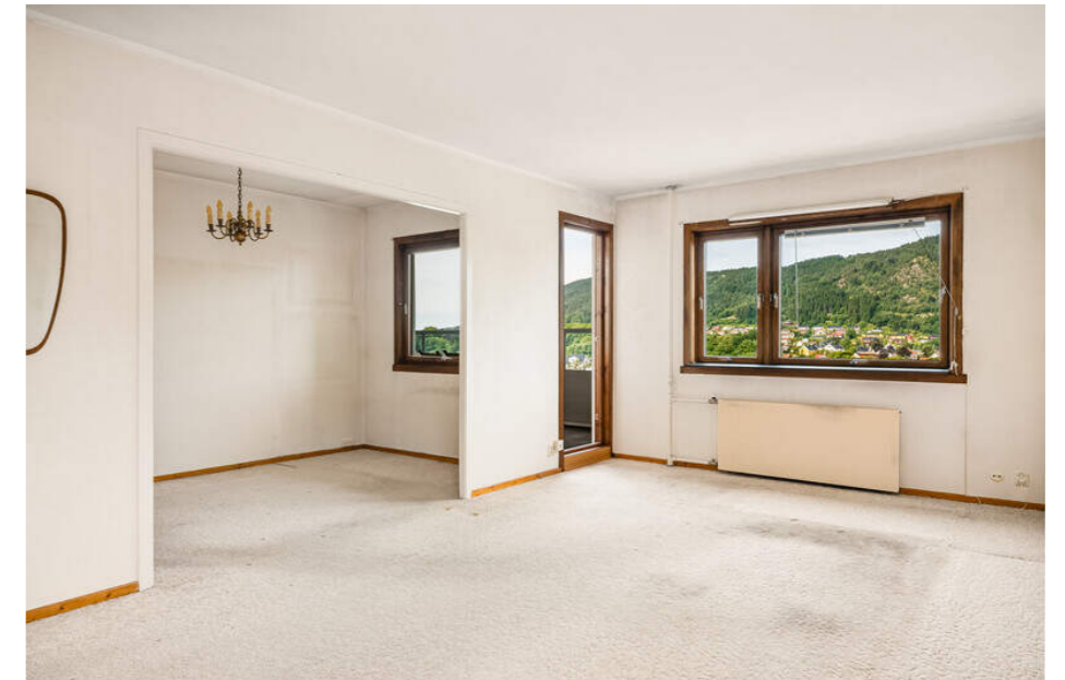
Radiatorovn i stuen som varmer opp leiligheten.
