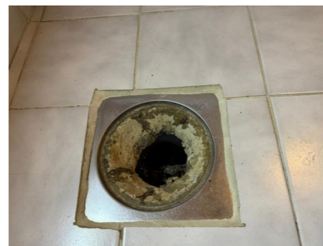
Eldre plastsluk i dusjsone. Ingen tegn til tettesjikt/membran.
