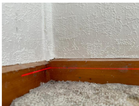
Bilder viser skjevheter i gulv i stue.
