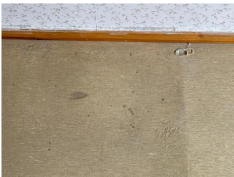
Slitasje i belegg på hovedsoverom.
