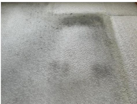
Misfarging i teppe i stue.
