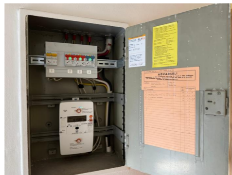
Sikringsskap i fellesarealer.
