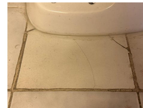
Sprekker i gulvflis v/ toalett.
