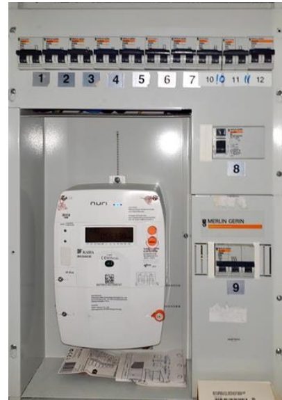
Elektrisk anlegg - [Sikringsskap]
