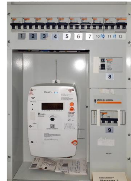
Elektrisk anlegg - [Sikringskap]
