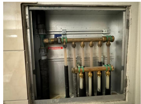
Rør i rør skap bør sjekkes for ev. lekkasje 2 ganger årlig.
