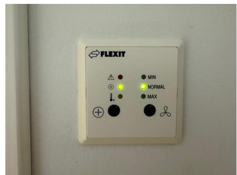
Bryterpanel i entre/gang. Bør stå på maks effekt v/ dusjing.
