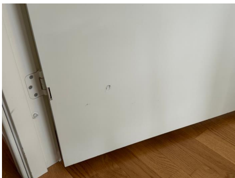
Overflatesår/mindre skade på soveromsdør.
