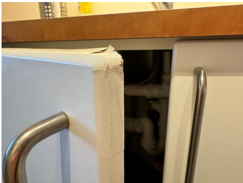
Delvis løs folie på kant av skapdør. Må anses å være normal slitasje.
