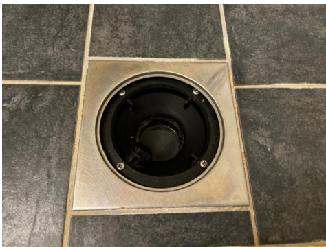
Plastsluk i dusjsone.
