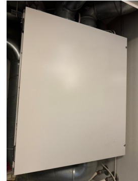
Luftbehandlingsaggregat på bad.
