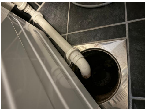
Plastsluk i gulv v/ vaskemaskin.
