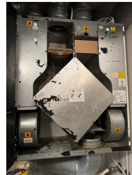
Innmat i luftbehandlingsaggregat.
