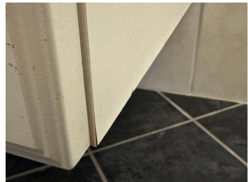
Fuktutsvelling i nedre del av baderomsinnredning.
