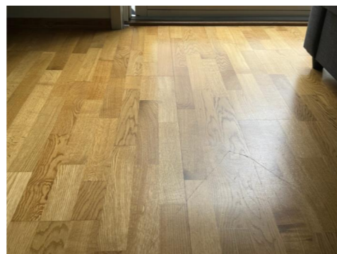
Slitasje/stripes i parkettgulv i stue.
