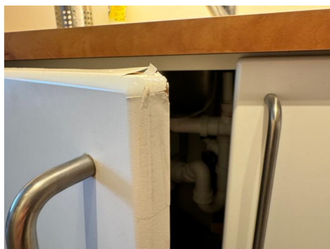
Delvis løs folie på kant av skapdør. Må anses å være normal slitasje. 2-ETG > KJØKKEN (5 M 2 )
