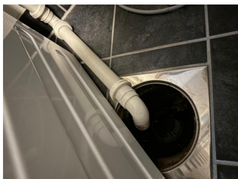
Plastsluk i gulv v/ vaskemaskin.
