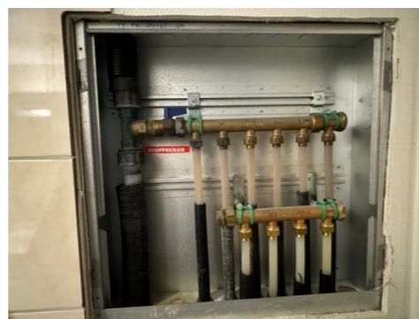
Rør i rør skap bør sjekkes for ev. lekkasje 2 ganger årlig.
