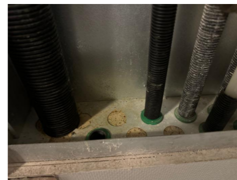
Tape under gjennomføringer tåler ikke fukt/stående vann i rør i rør skap. Bunn i rør i rør skap bør smøres med membran med oppbrett.
