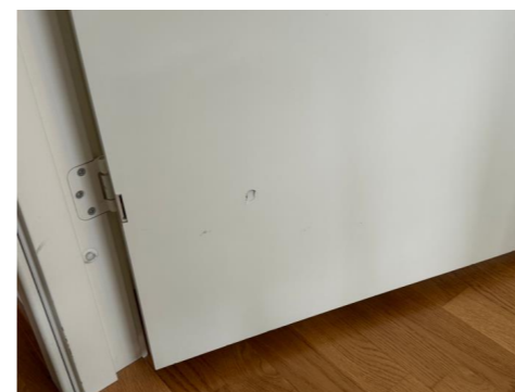
Overflatesår/mindre skade på soveromsdør.
