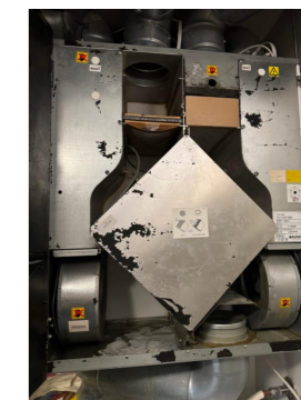
Innmat i luftbehandlingsaggregat.
