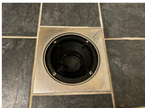
Plastsluk i dusjsone.
