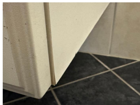
Fuktutsvelling i nedre del av baderomsinnredning.
