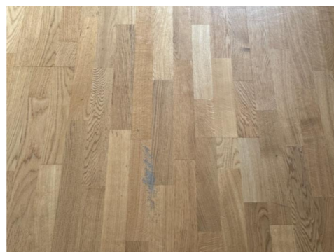
Slitasje/stripes i parkettgulv i stue.
