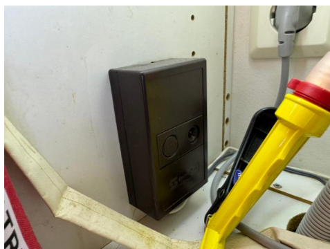
Lekkasjestopper fra byggeår.
