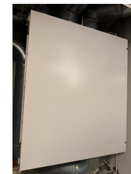
Luftbehandlingsaggregat på bad.
