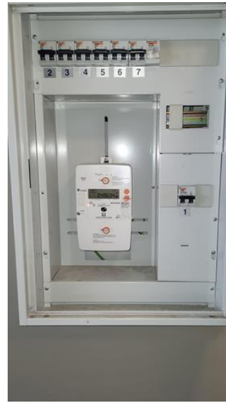
Elektrisk anlegg - [Sikringskap]
