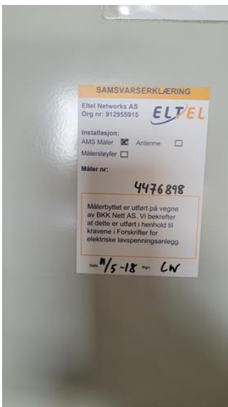
Elektrisk anlegg - [Samsvarserklæring AMS-måler]
