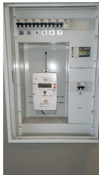
Elektrisk anlegg - [Sikringskap]
